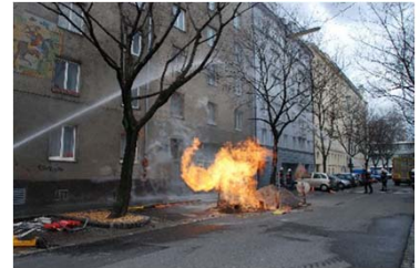
Wien 2009: Umgebung löschen und kühlen / 3 Rohre, 1 Hydrocell
